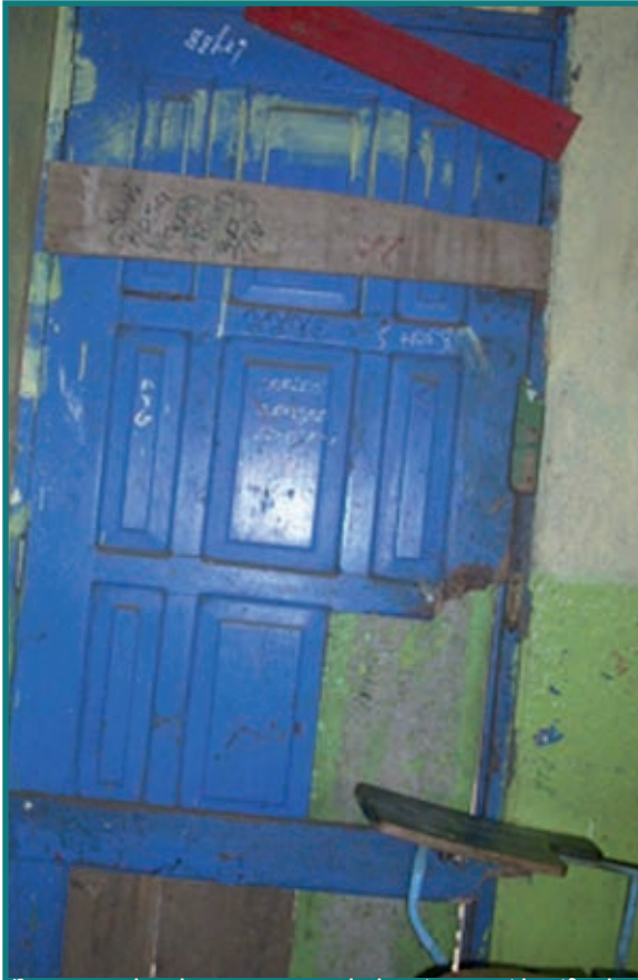
Puertas condenadas por su avanzado deterioro, son identificadas por los maestros como parte del riesgo en los salones.
