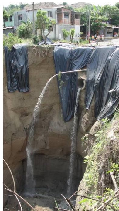
Vista de la cárcava en la comunidad Las Cañas.
