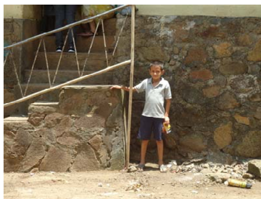
Nivel hasta el que llegó el agua durante la inundación (tercer escalón).
