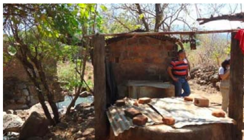
Pared con marca de la crecida del río
